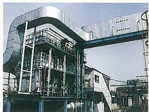
排ガス燃焼装置
