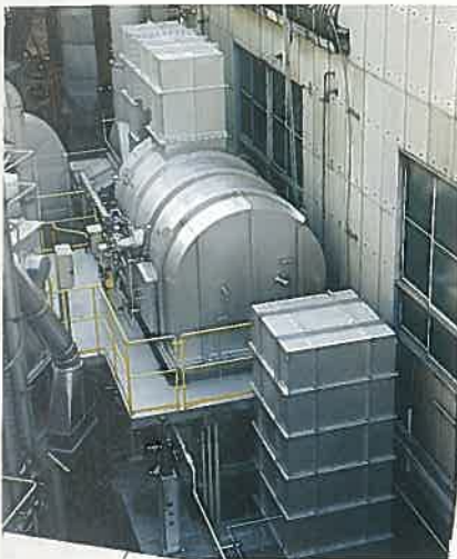
新たに導入した排ガス燃焼処理装置
