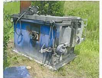
廃止した広島工場の小型焼却炉
