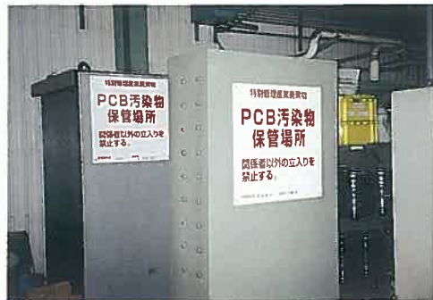
新川工場PCB廃棄物保管状況
