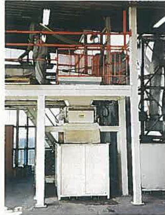
新川工場に設置したメラミン化粧板破砕機
