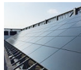
太陽電池パネル
