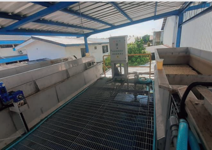
更新した水処理装置の一部
