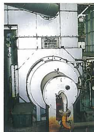
■排ガス脱臭装置
