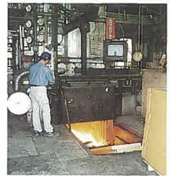
■資源回収ボイラー
