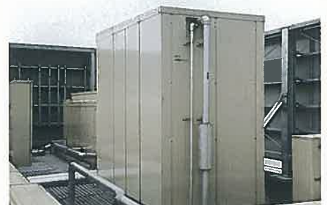
甚目寺工場事務棟氷蓄熱ユニット
