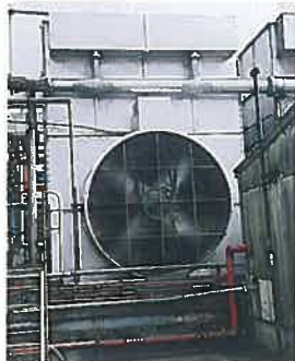
冷却塔と300t水槽
