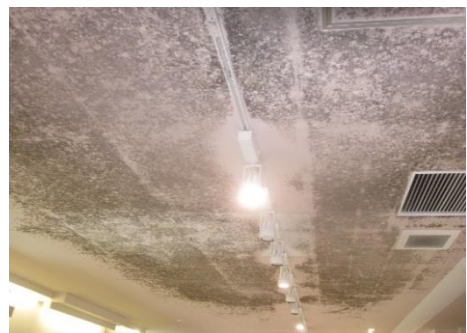
カビが発生した店舗天井
