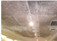
カビが発生した店舗天井
